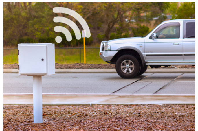
L'armoire routière comprend un panneau solaire, une batterie de secours et un modem.
